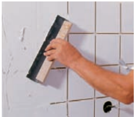
11 Nachdem die letzten Fliesen geklebt sind und der Kleber trocken ist, wird die angerührte Fugenmasse mit einer Gummirührer eingewischt.
