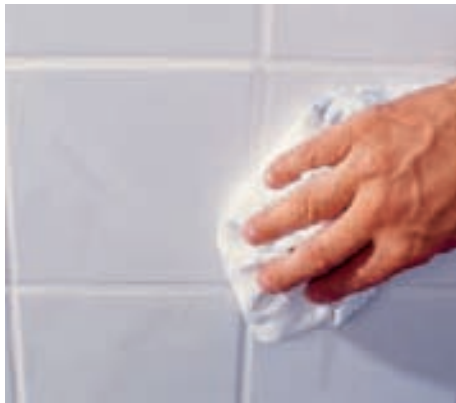
15 Sind alle Verfugungen trocken (Silikon braucht einen Tag), wird der Fugenmasse-Schleier mit einem weichen Tuch trocken abgewischt.
