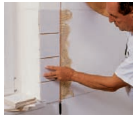
3 An einer Außenecke beginnend, wird die erste, senkrechte Fliesenreihe geklebt und an einem Senklot ausgerichtet.
