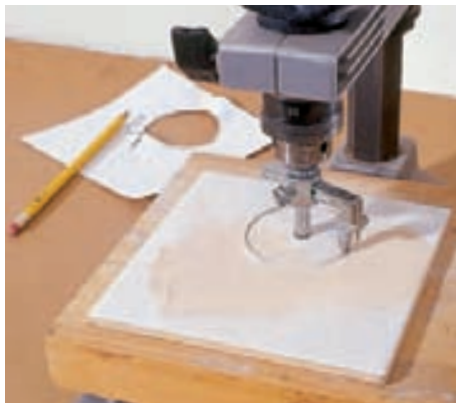
10 Ein spezieller Kreisschneider wird mit der Schablone auf den Ausschnittumfang eingestellt, auf der Fliese positioniert, dann das Loch gebohrt.
