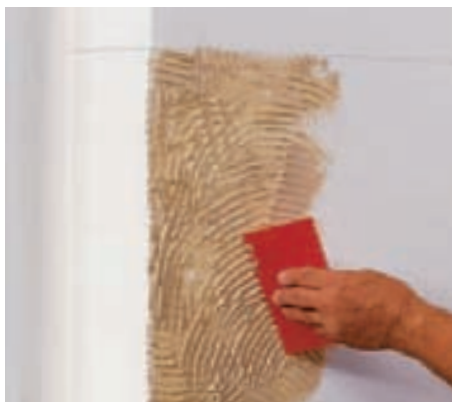
2 Mit einem Zahnspachtel (Zahnung nach Herstellerangabe) wird jetzt der Kleber für die erste Fliesenreihe auf die Wand aufgezogen.
