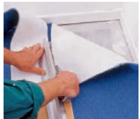
5 Das Ende des hochstehenden Teppichs in der Ecke wird auf einem Holzbrett mittels Schiene und Cuttermesser abgeschnitten.
