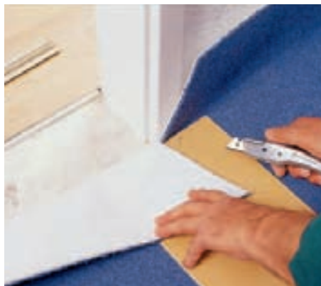
4 Um den Teppich durch die Türöffnung zu legen, wird der Schnitt schräg zur Türleibung geführt. Später wird exakt nachgeschnitten.
