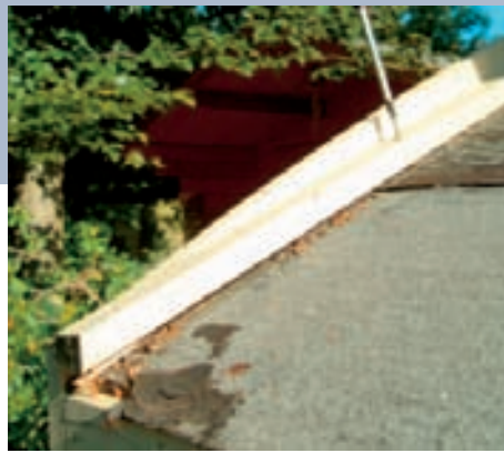
3 Abschlussleisten mit unversiegelten Fugen verrotten, weil Wasser nicht abtrocknen kann. Sie sollten verschwinden oder versiegelt werden.
