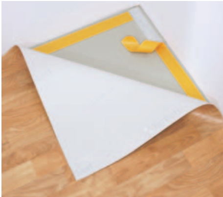
6 Die fertig zugeschnittenen Böden können nun mit dem vorbereiteten Klebeband von den Raumecken aus beginnend fixiert werden.
