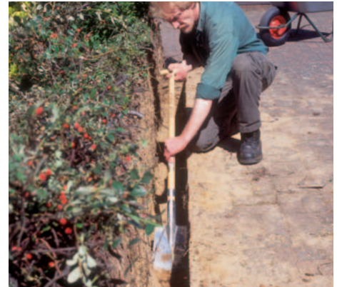
5 Der Grabenboden wird mit dem Spaten geebnet. Beachten Sie, dass die Grabenwände exakt gerade und nicht schräge (v-förmig) sind.
