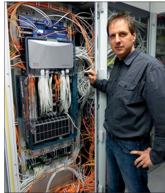
Der Leiter IT-Infrastruktur des hr, Jürgen Senft, vor einer zentralen Komponente des neuen hochverfügbaren Netzwerkes – dem Data Center-Switch Cisco Nexus 7000
