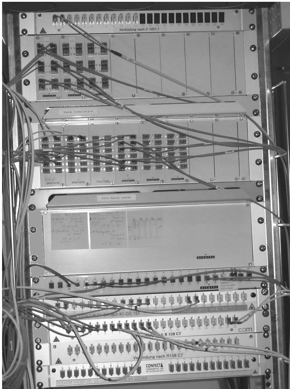
Abbildung 14.20 Rangierpanel eines LWL-Verteilers in der Netzwerkzentrale
