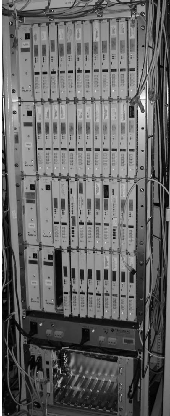
Abbildung 14.12 Ein Rack mit WAN-Modems. Jedes Modem erschließt über eine Mietleitung ein oder mehrere Gebäude.
