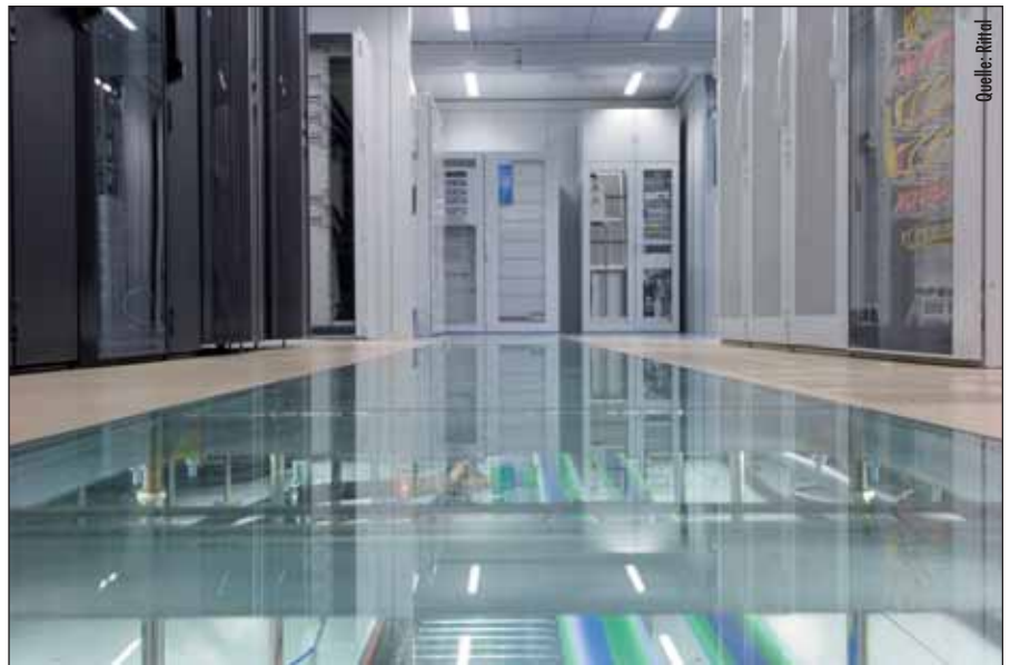
Der Server-Schrank ist ein Baustein im gesamten IT-Infrastrukturkonzept, welches das "System Rechenzentrum" bildet
