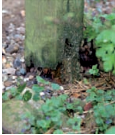
Höchste Zeit: Wenn Pfosten so aussehen, muss dringend Abhilfe geschaffen werden. Auch wenn sie oben noch tadellos aussehen, die Stabilität eines Bauwerks ist ernsthaft gefährdet.
