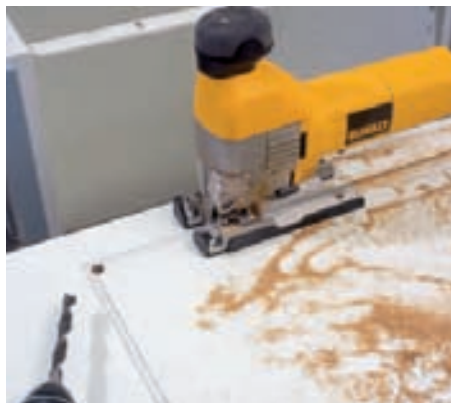
9 Mit der Elektrostichsäge wird der eingezeichnete Bereich ausgesägt. 10-mm-Löcher in den Ecken helfen, eine saubere Kurve zu sägen.
