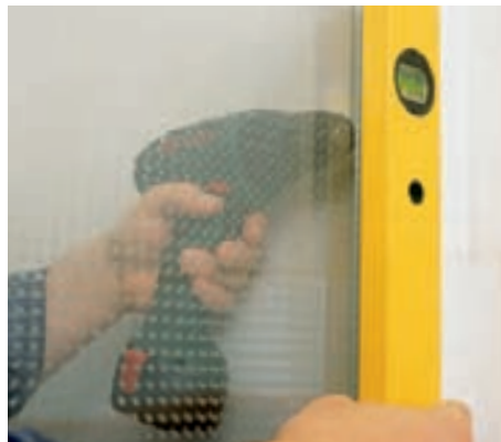
14 Die Glaselemente an den U-Schienen mit der Wasserwaage ausrichten, dann mit dem 2,5-mm-Bohrer vorbohren und anschrauben.
