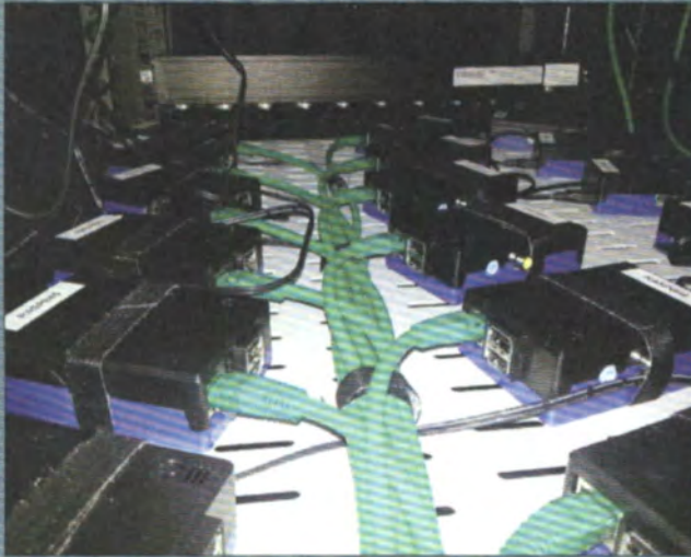
1 Eine Raspberry-Pi-Kolonie im Server-Rack.
